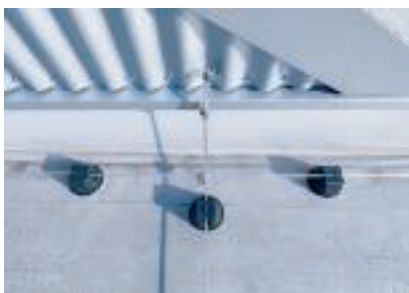
Facciata metallica collegata all'impianto parafulmine
